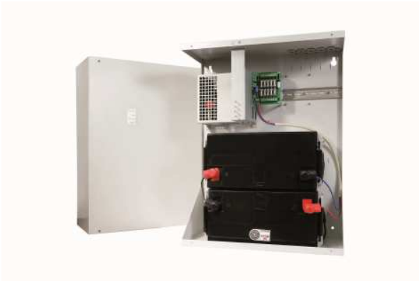
Bild 2: DC-USV mit Akkumulatoren
